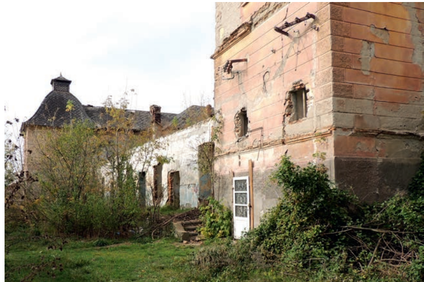
HD-II-a-A-03270 Ansamblul castelului contelui Jozsika sat BRĂNIȘCA; comuna BRĂNIȘCA (castel, capela, ziduri incinta) - stare avansata de degradare, interventii nefericite in timp
