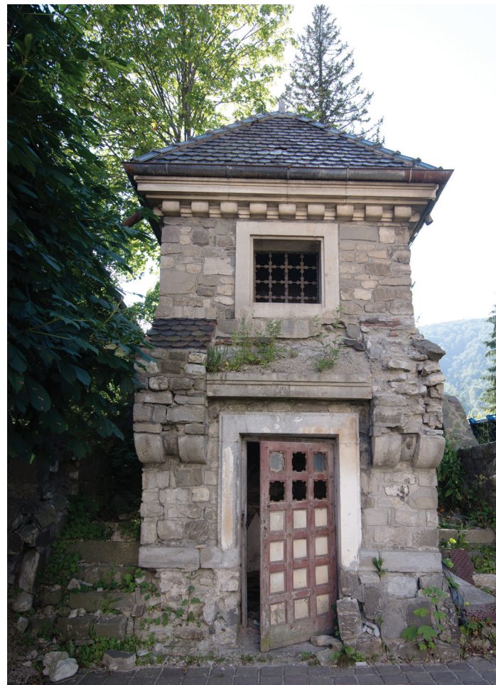
Punct de transformare, Azuga
